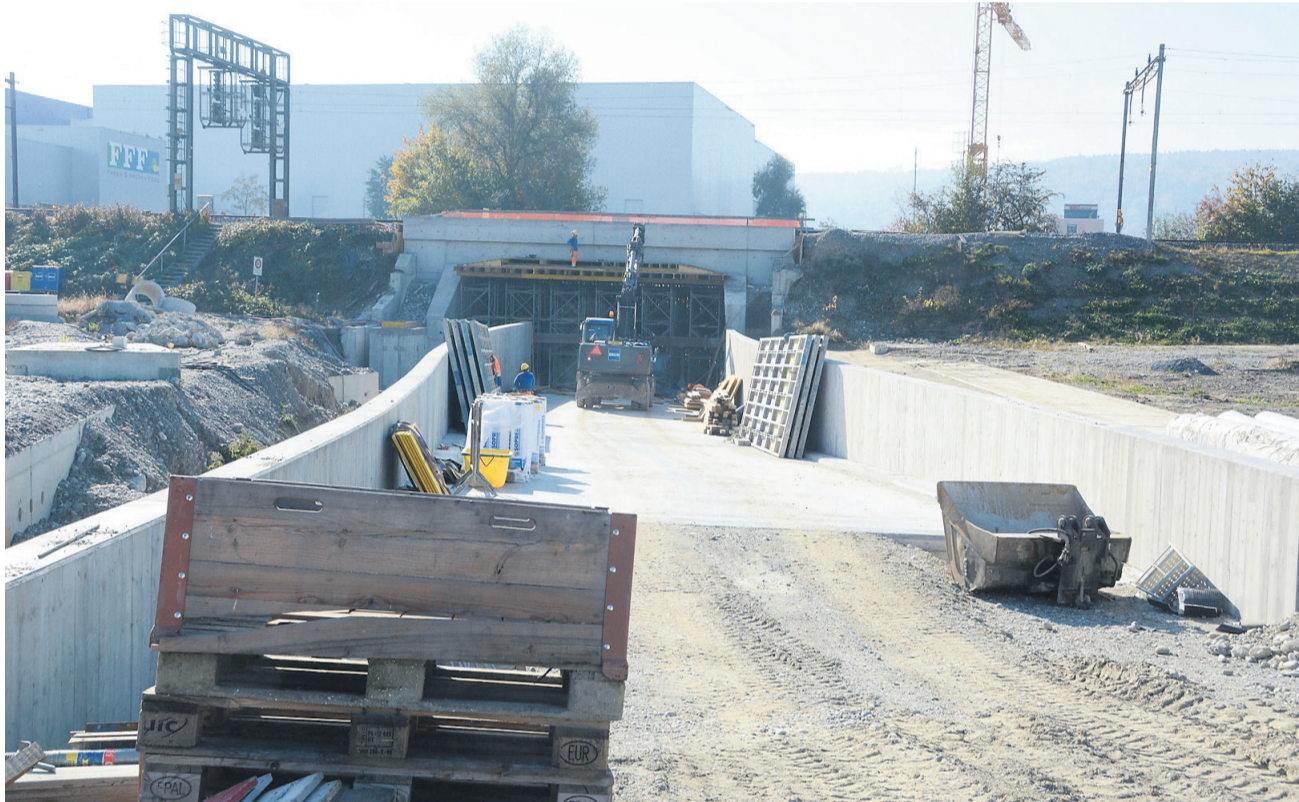
So präsentiert sich die neue Zufahrt zur Unterführung auf der Wohler Seite. In Zukunft ist das Kreuzen an dieser Stelle problemlos möglich. Die Mauer links zeigt den späteren Verlauf des Fuss- und Veloweges.
