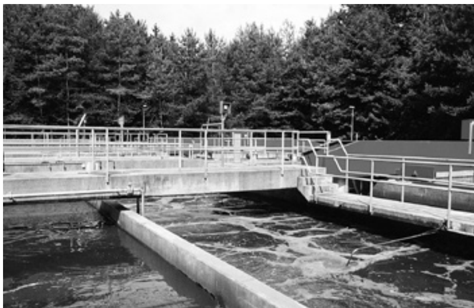
In diesem Becken läuft der biologische Abbau ab. Das Bild zeigt die mittelgrosse ARA Rapperswil.
