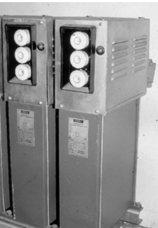
Einzelgesicherte Kondensatorengruppe in einem lebensmittelverarbeitenden Betrieb. Da die Sicherung direkt auf den Kondensatoren steht, ist für Ortsunkundige deren Auffindung äusserst schwierig.
