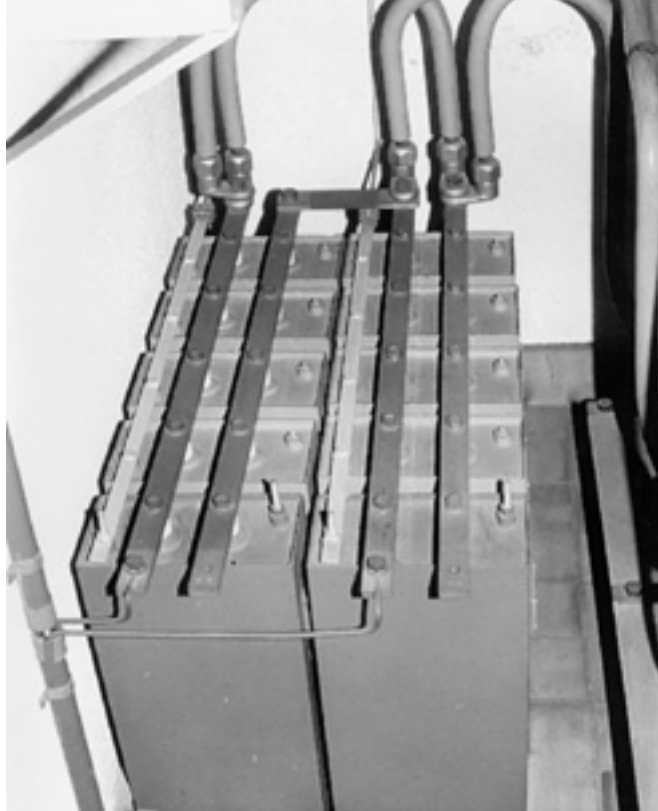
Kondensatorengruppe in der Pumpstation einer Trinkwasserversorgung. Diese als Hochspannungs-Kompensation bezeichnete Anlage befindet sich in einem separaten Raum der Pumpstation.
