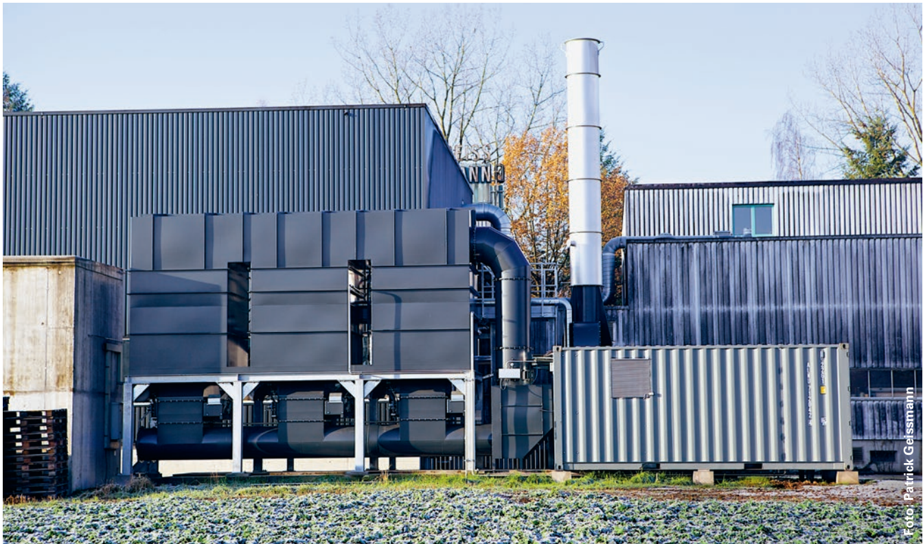
In einer thermischen oder regenerativen Nachverbrennungsanlage werden VOC aus der Abluft verbrannt. Dabei entsteht zwar Kohlendioxid CO 2 . Doch die Verbrennungswärme wird beispielsweise für Heizzwecke oder Warmwasseraufbereitung eingesetzt, was zusätzlichen Brennstoff einspart.
