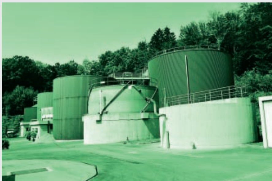
Faulungsanlage der ARA Bremgarten-Mutschellen mit Schlammfermentern, Gasbehälter und Abgabebehälter.
