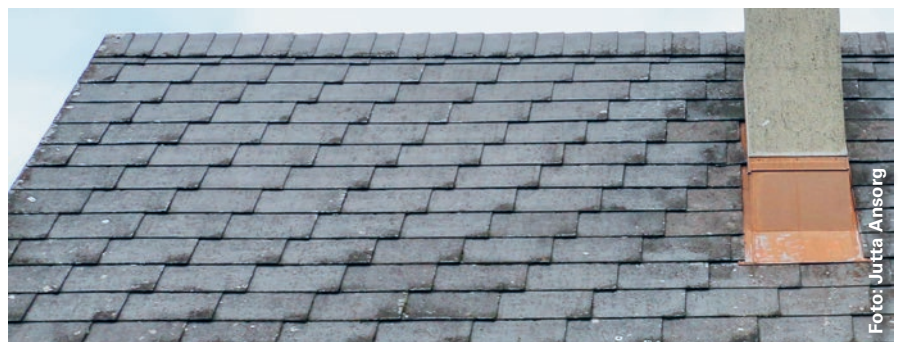
Dieses Faserzementdach hat seine Lebensdauer erreicht und muss saniert werden. Auch bei intaktem Zustand darf auf asbesthaltigen Dachoberflächen keine Solaranlage montiert werden.
