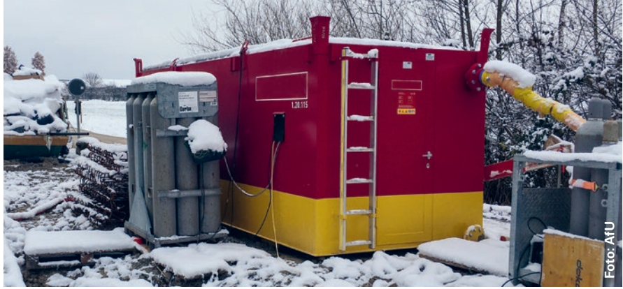
Neutralisationsanlage mit einem Bündel CO 2 -Flaschen: Saure und alkalische Baustellenabwässer müssen nach der Neutralisation einen pH-Wert zwischen 6,5 und 9,0 aufweisen.
