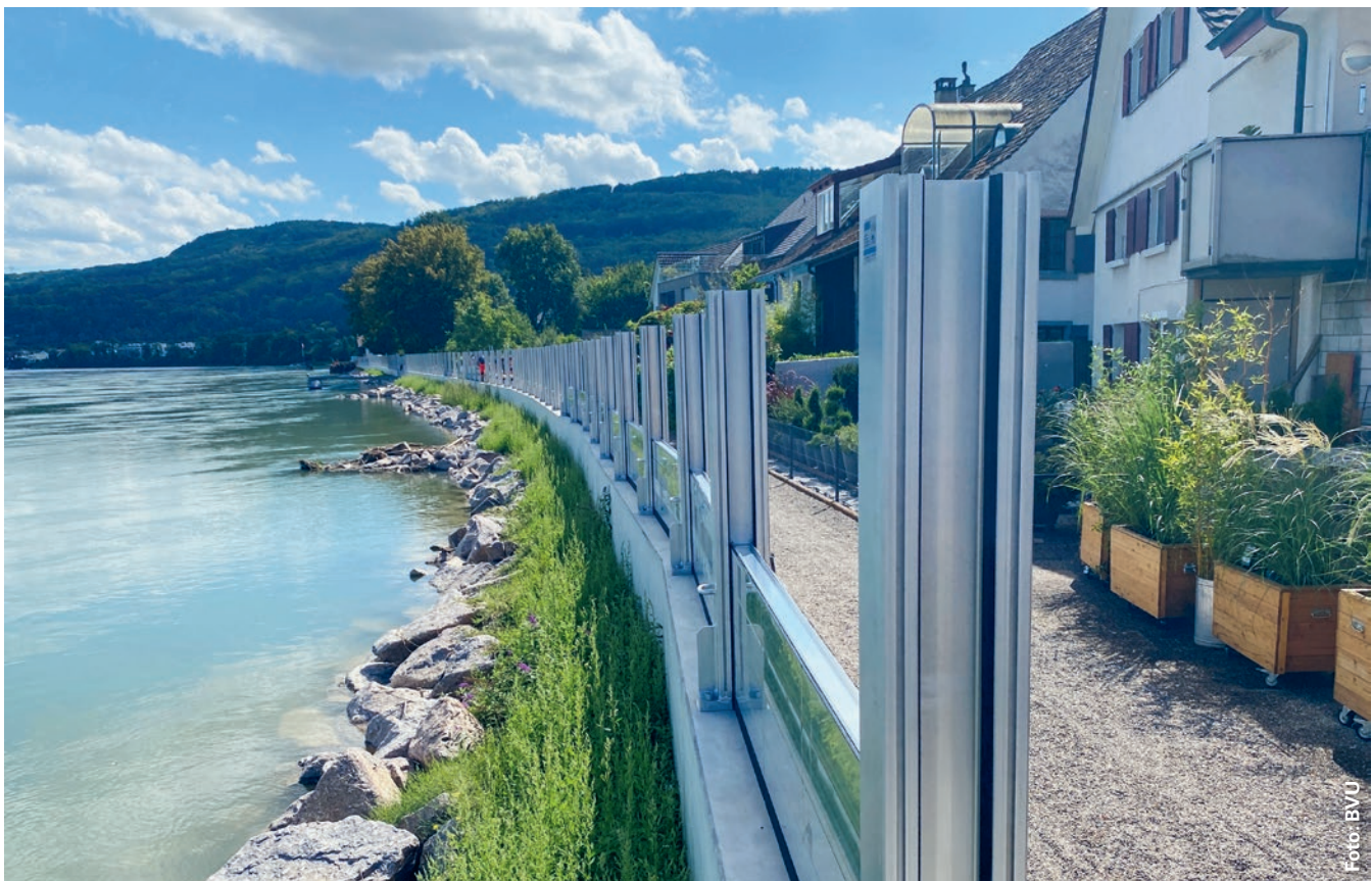
Die Hochwasserschutzmauer in Wallbach kann mit Aluminiumelementen auf zwei Meter erhöht werden: so sieht zeitgemässer Hochwasserschutz aus.
