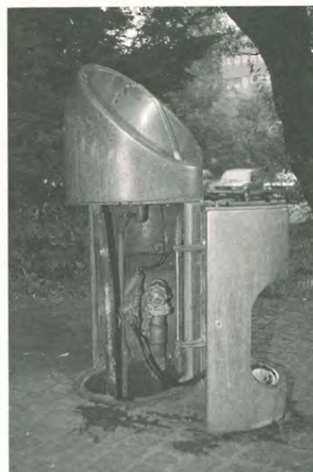
Im Inneren dieser Brunnen sind Installationen vorhanden, die es erlauben, im Katastrophen- fall sauberes Trinkwasser an die Bevölkerung abzugeben. (Foto: Stefan Binder, Abteilung Umweltschutz)
