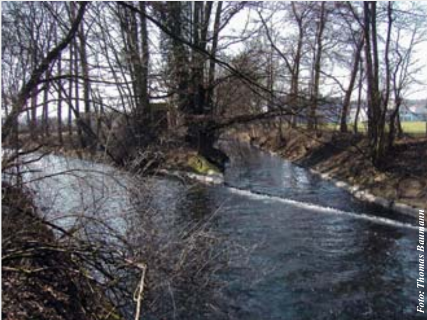
Hier fließt die Uerke in die Suhre. Die beiden Gewässer wurden 1943 kanalisiert. Mit Betonplatten und Steinpflasterungen wurden die Ufer vor Erosionen geschützt. Im Bereich des Zusammenflusses wurde die Bachsohle betoniert.
